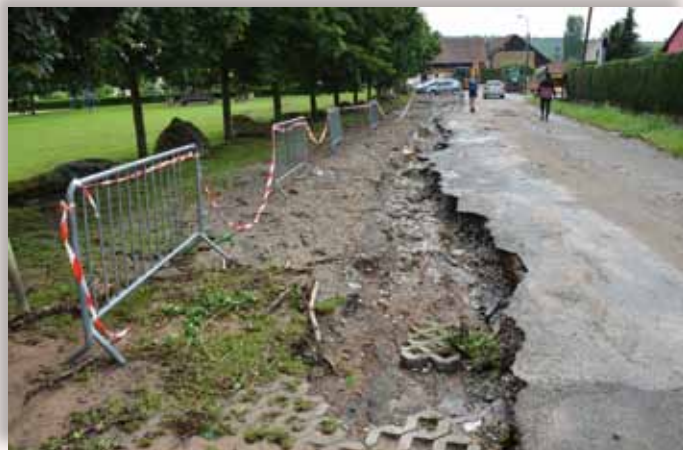
Les dégâts provoqués par l'orage exceptionnel du 8 juin 2016
