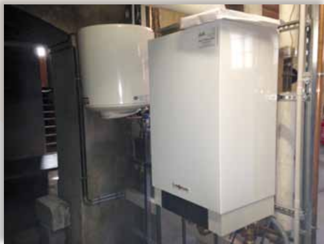
Nouvelle chaudière à la maison des associations
